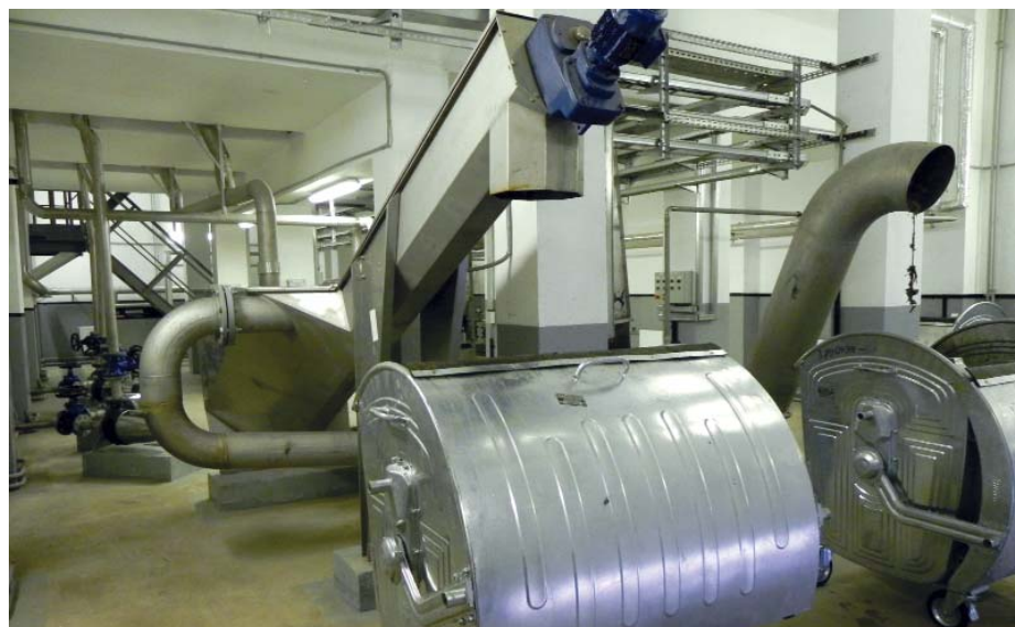
Головная часть очистных сооружений, система удаления песка и ТБО
