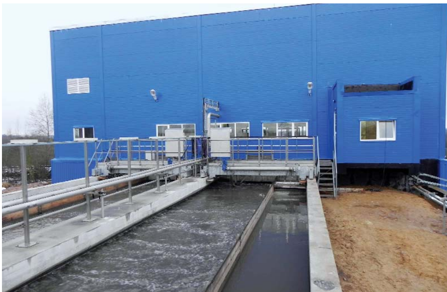
Головная часть очистных сооружений, песколовки
