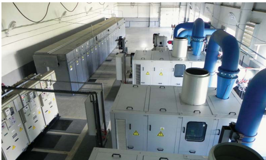
Машинный зал блока насосных и воздушных станций
